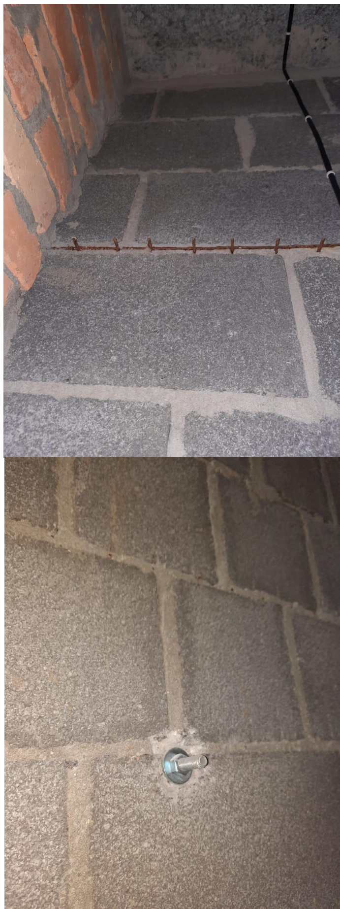
Фотография 24-25. Посторонние предметы, не предусмотренные конструкцией.
