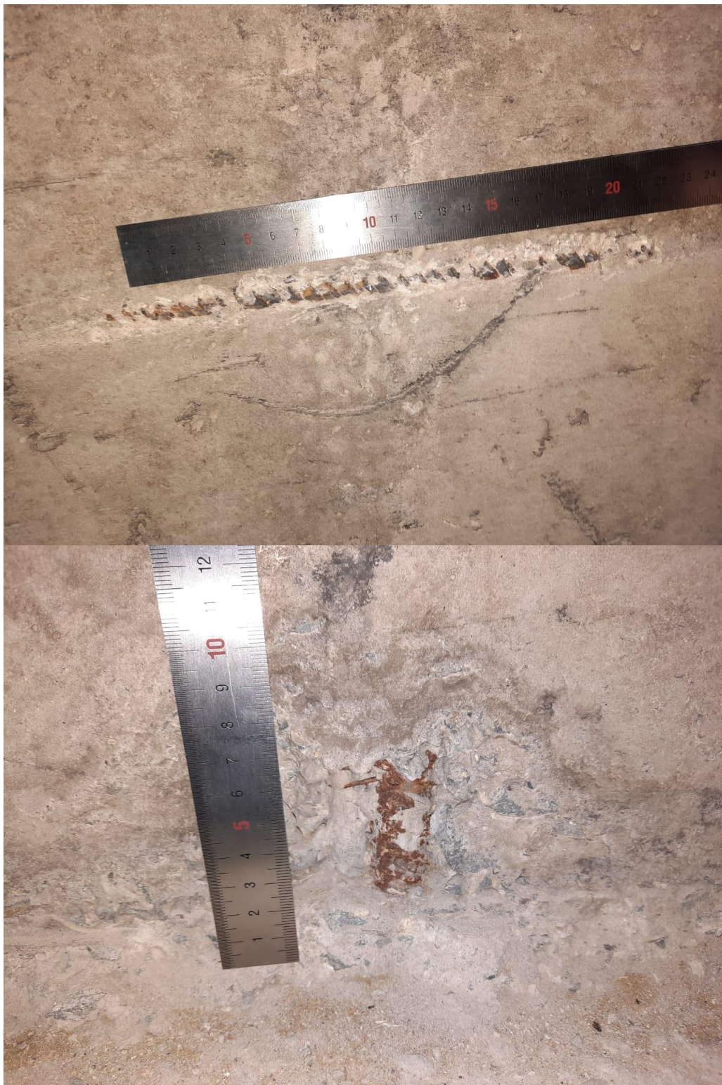
Фотография 4-5. оголения стержня рабочей арматуры в стенах монолита помещения
