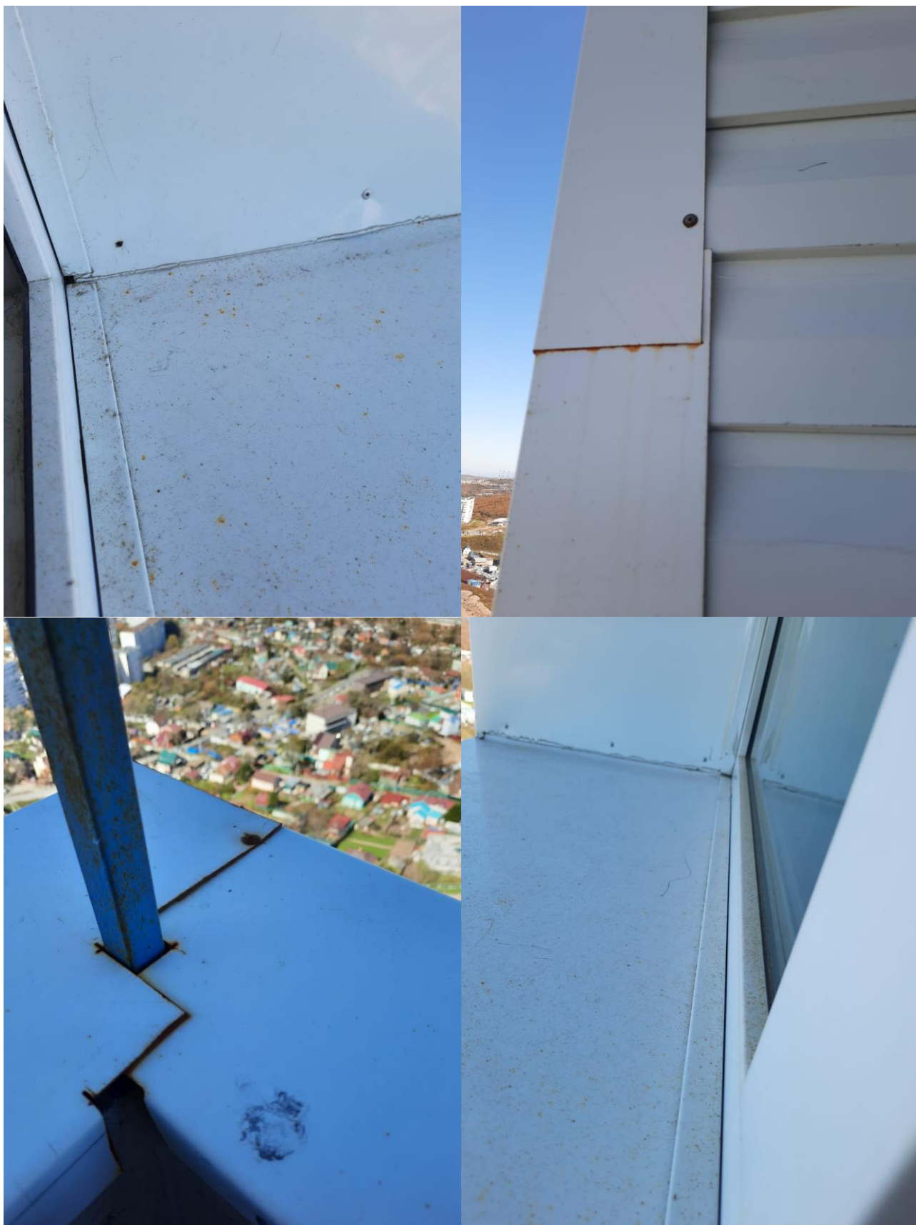
Фотографии 24-27. Следы коррозии
