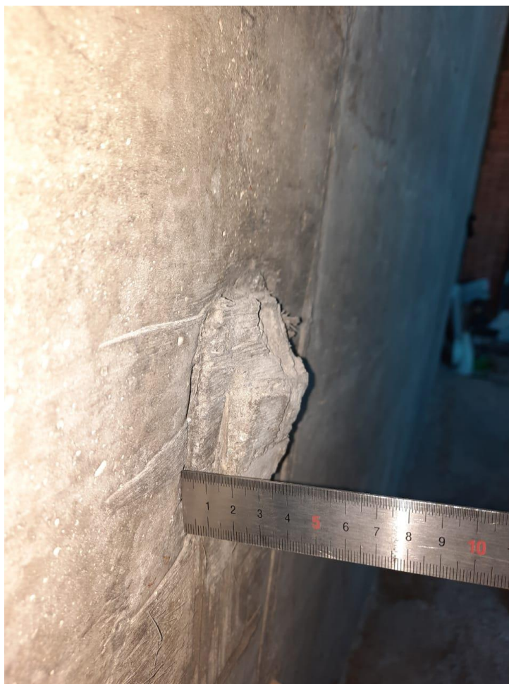
Фотография 3. Наплавы бетона
