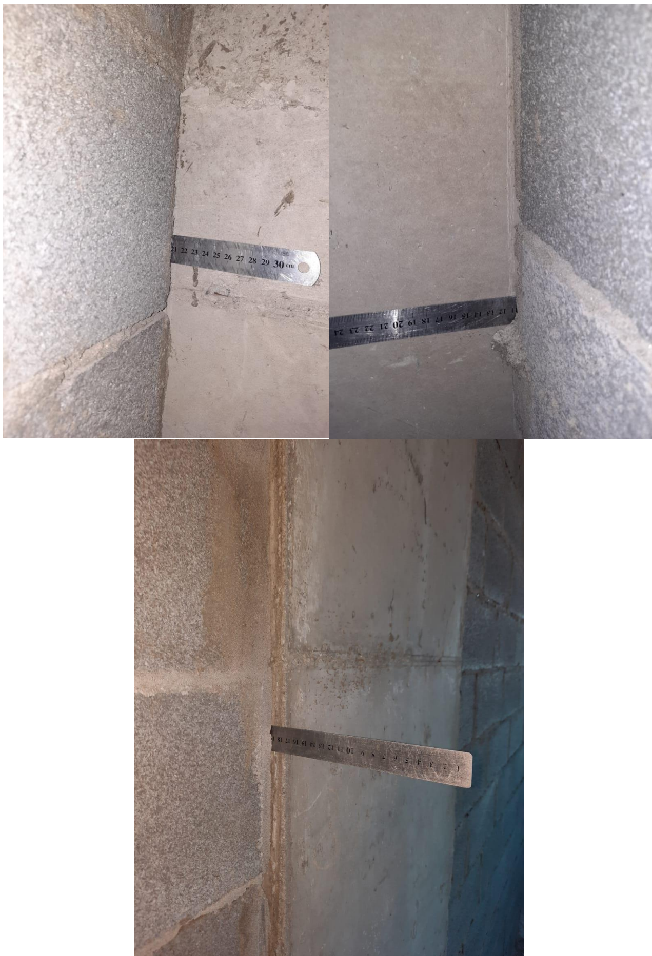
Фотография 19-21. Сквозное растрескивание в узлах сопряжения «блок-бетон»
