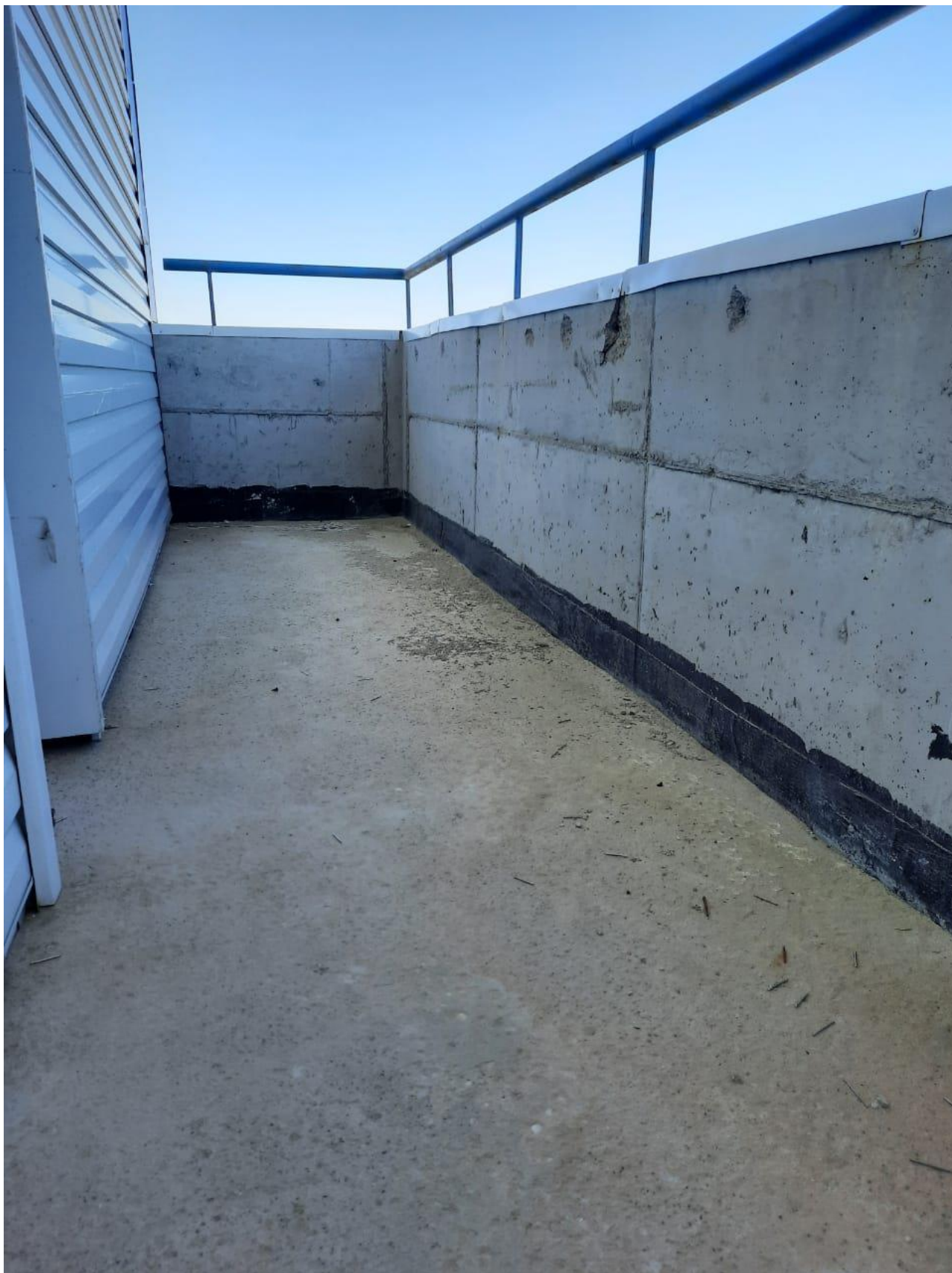
Фотография 8. Лоджия отсутствие дренажных сливов
