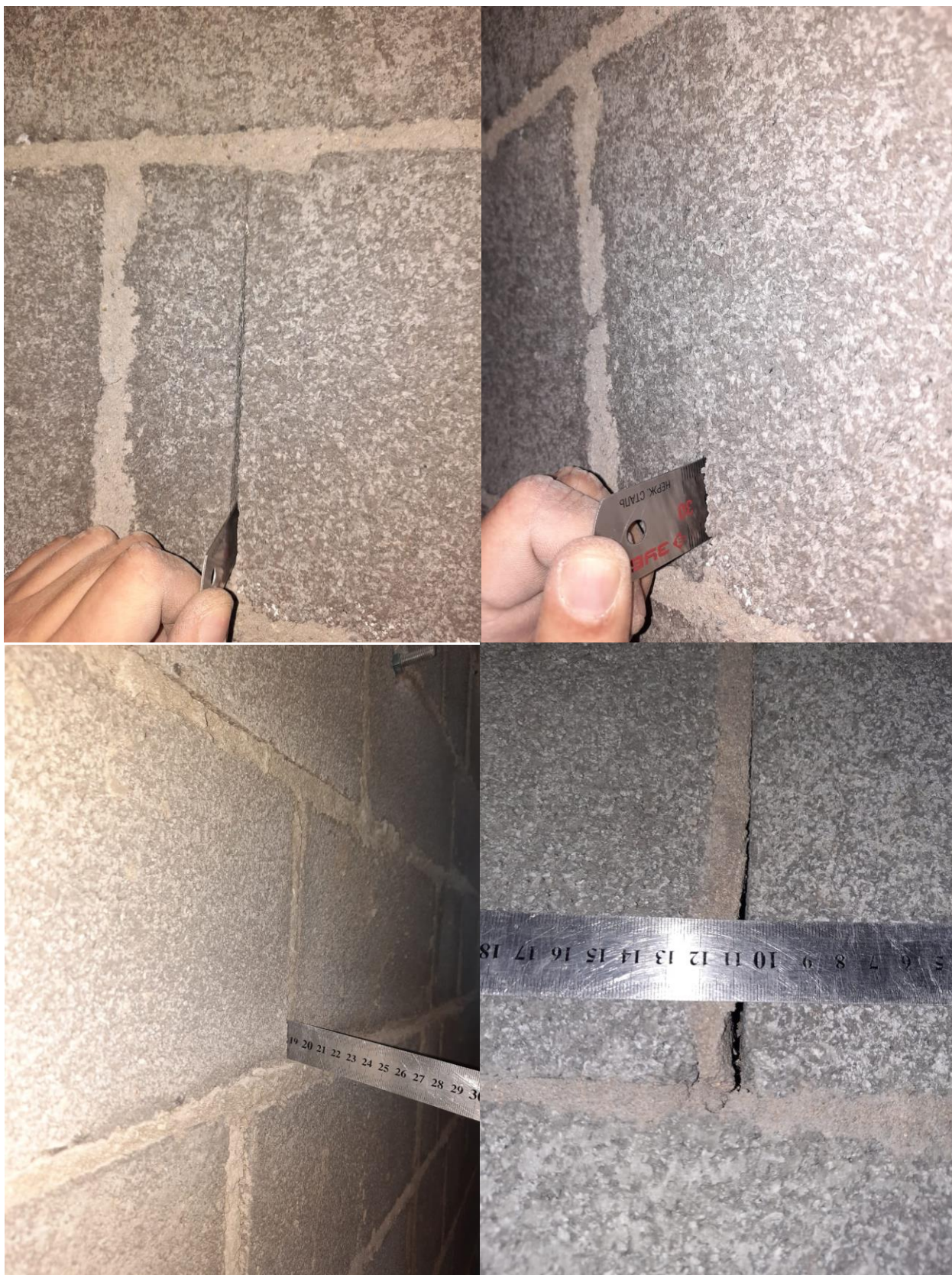
Фотография 13-18. Дефекты кладки
