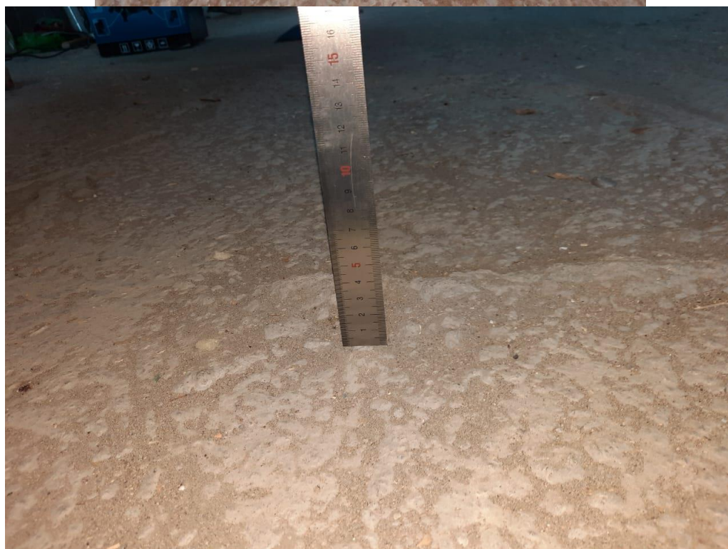
Фотографии 6-7. Наплавы бетона пол.
