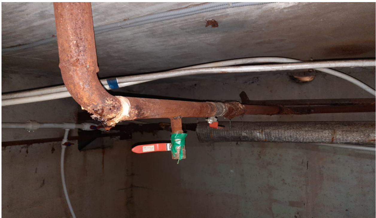
Фотографии 8-9. Коррозия , протечки.
