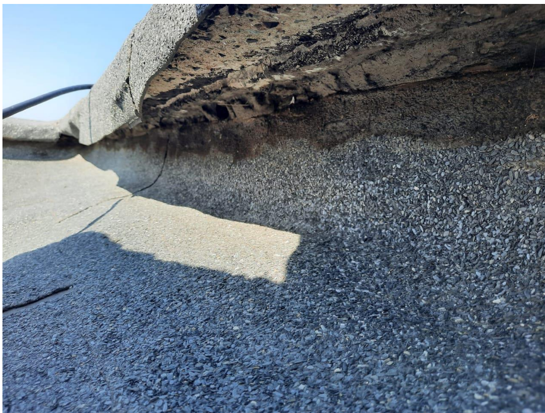
Фотография 6. Отслоение гидроизоляционного слоя.
