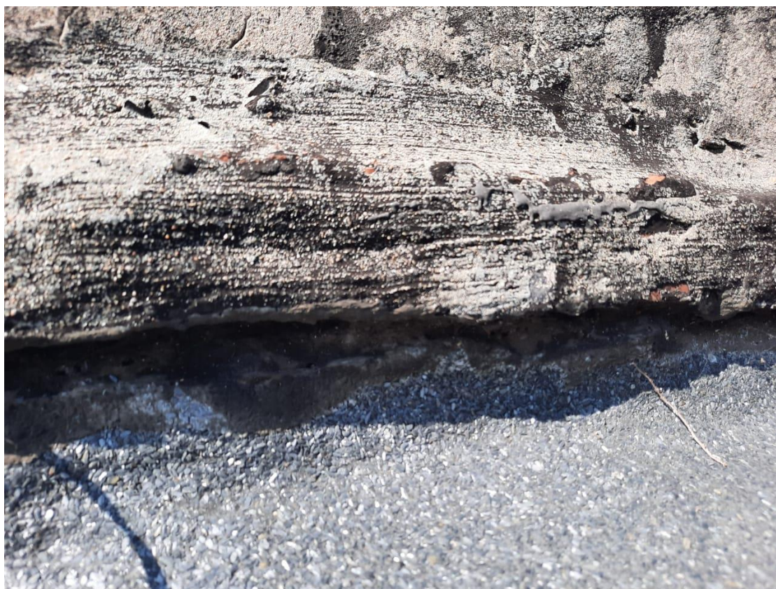
Фотография 7. Отсутствие примыкания кровли с наплавом на вент. каналах
