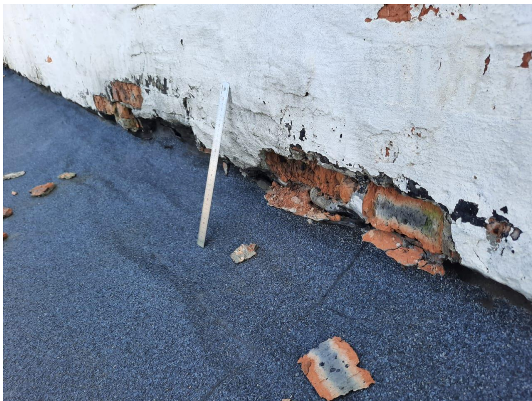
Фотографии 4-5. Повреждение кирпичной кладки, отсутствие примыкания кровли на стену надстройки
