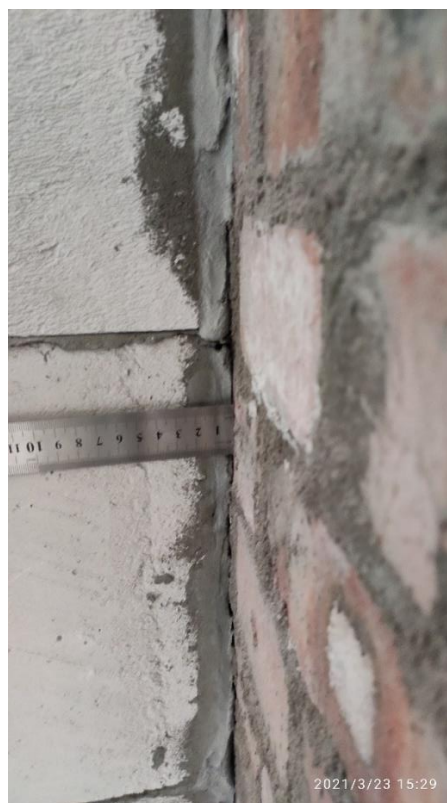
Фотографии 11-19 Дефект кладочного шва перегородок, внешних стен в местах сопряжения перегородок из мелкоштучных материалов между собой и монолитом
