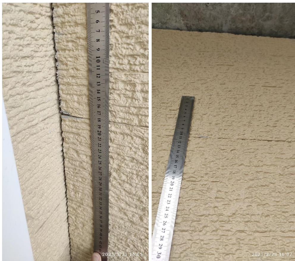
Фотографии 49-50. Повреждения внешней части фасадных панелей.
