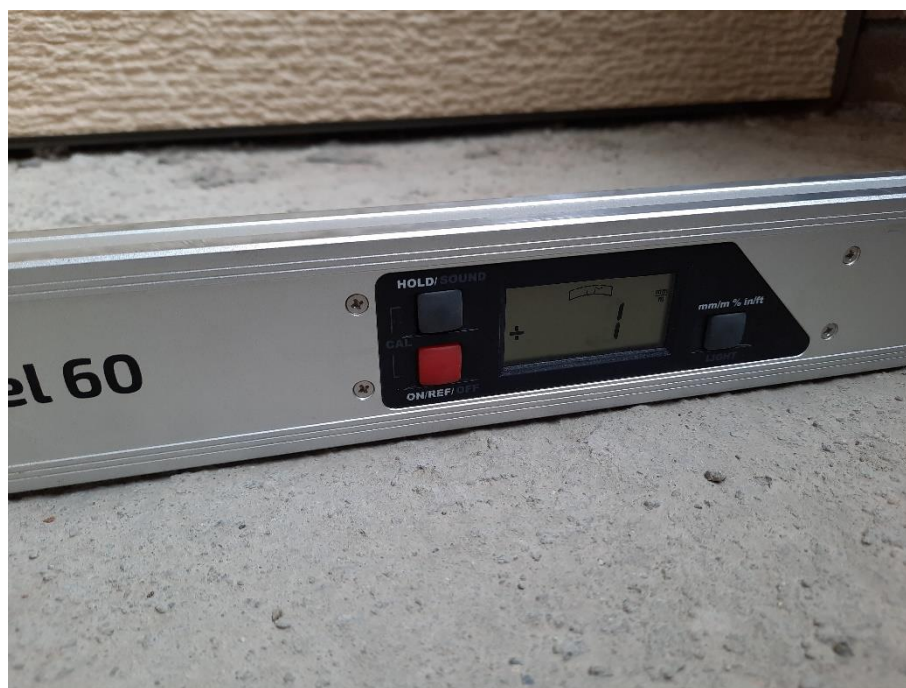
Фотографии 36-39. Обратный уклон перекрытий лоджии/балкона.
