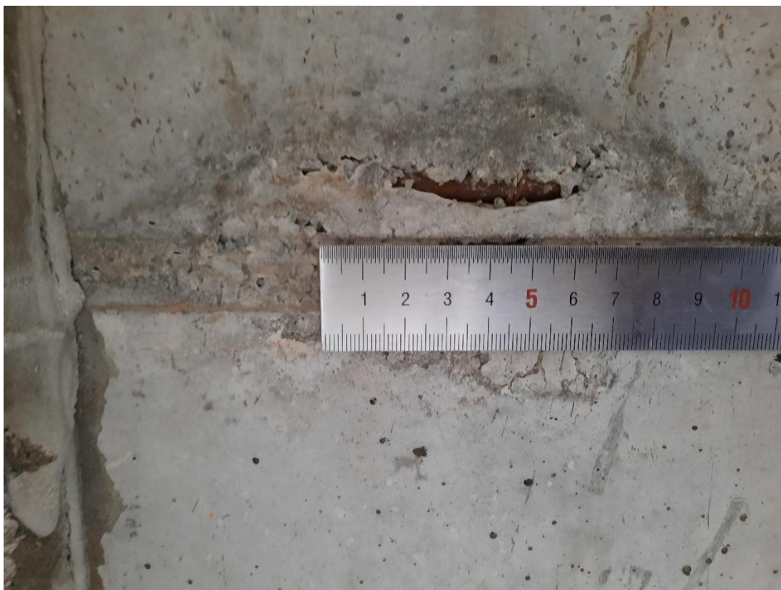
Фотография 1,2,3. Оголения стержня рабочей арматуры в стенах монолита помещения
