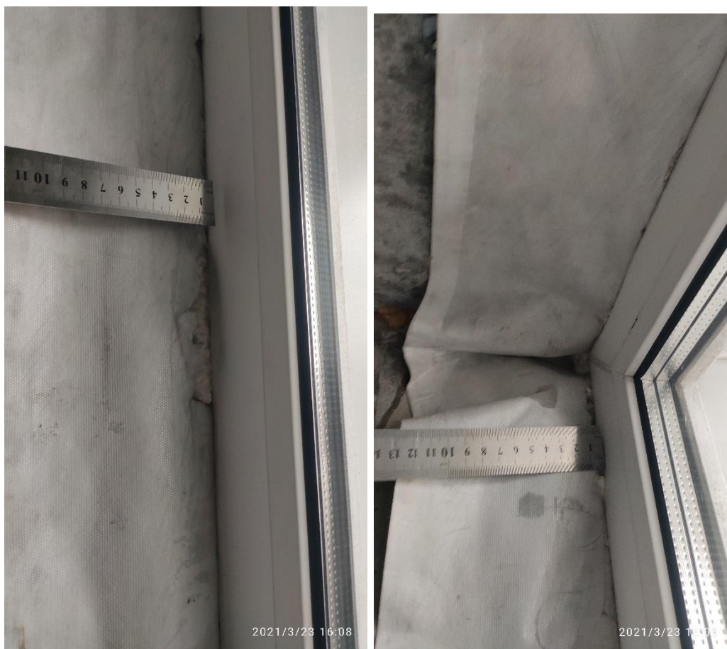
Фотографии 47-48. Повреждения ветрозащитной мембраны.
