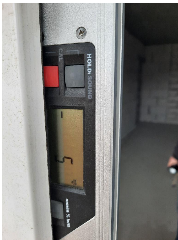
Фотографии 51-53. Оконные блоки установлены с отклонением от вертикали более 1,5 мм на 1м длины изделия.
