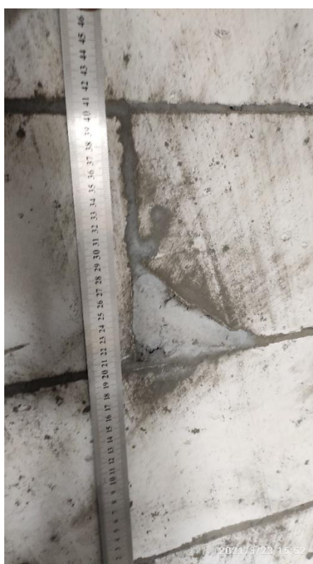
Фотографии 23-25. Пропуски в кладке и отбитые углы у элементов блочной кладки.
